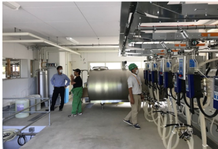
ミルカー自動搬送機
