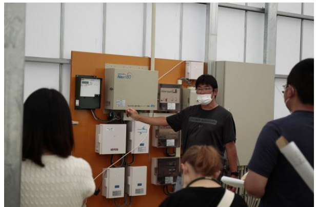
環境制御盤の説明を伺う様子
